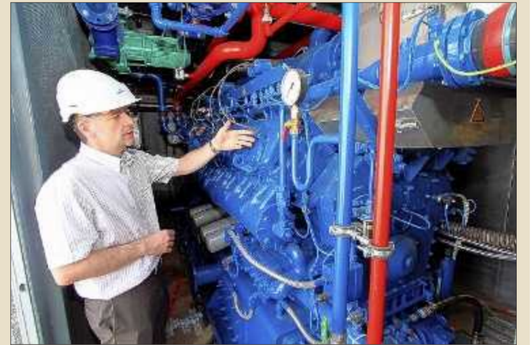
Serge Winkelmüller montre les énormes moteurs qui seront alimentés par le biogaz issu de la dégradation de nos biodéchets. Ou quand nos restes de repas deviennent gaz, puis électricité, ou chaleur.
